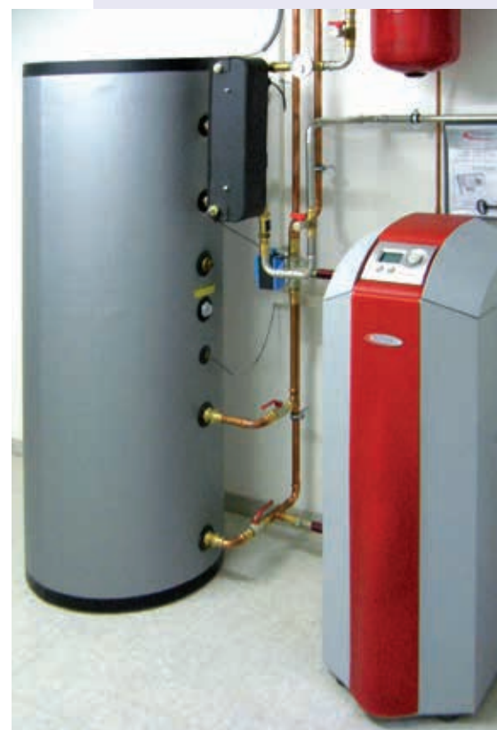
Warmwasserboiler (links) und Wärmepumpe.
